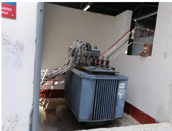
Figura 8. Transformador de potencia
