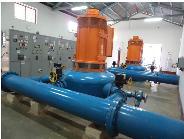
Figura 14. Generadores de la CH SHIPILCO
