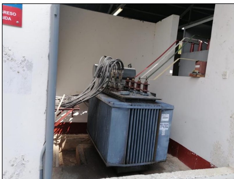
Figura 13. Transformador de la CH SHIPILCO
