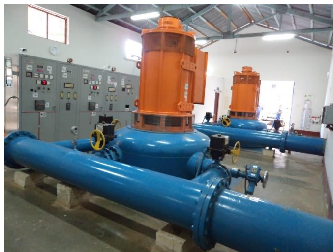
Figura 7. Vista interna de la sala de máquinas
