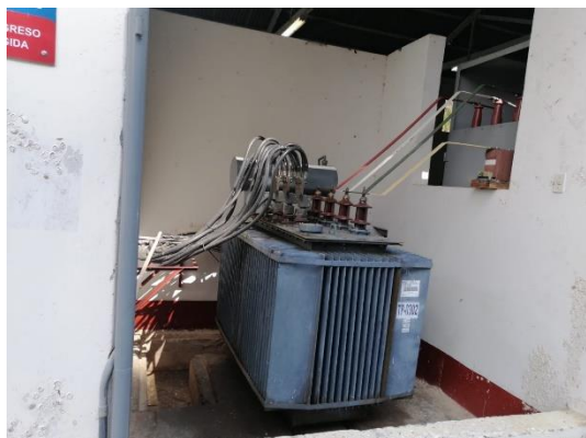
Descripción: transformador de potencia
