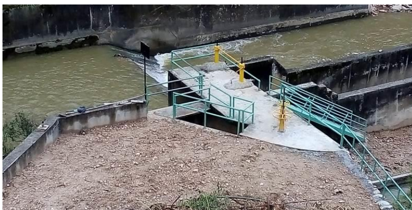
Figura 1. Toma de captación
